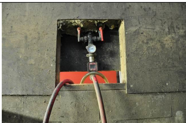
Figur x. Vandmængde og vandtemperatur kan let bestemmes i det aggerpumpe-lignende pumpesystem.
